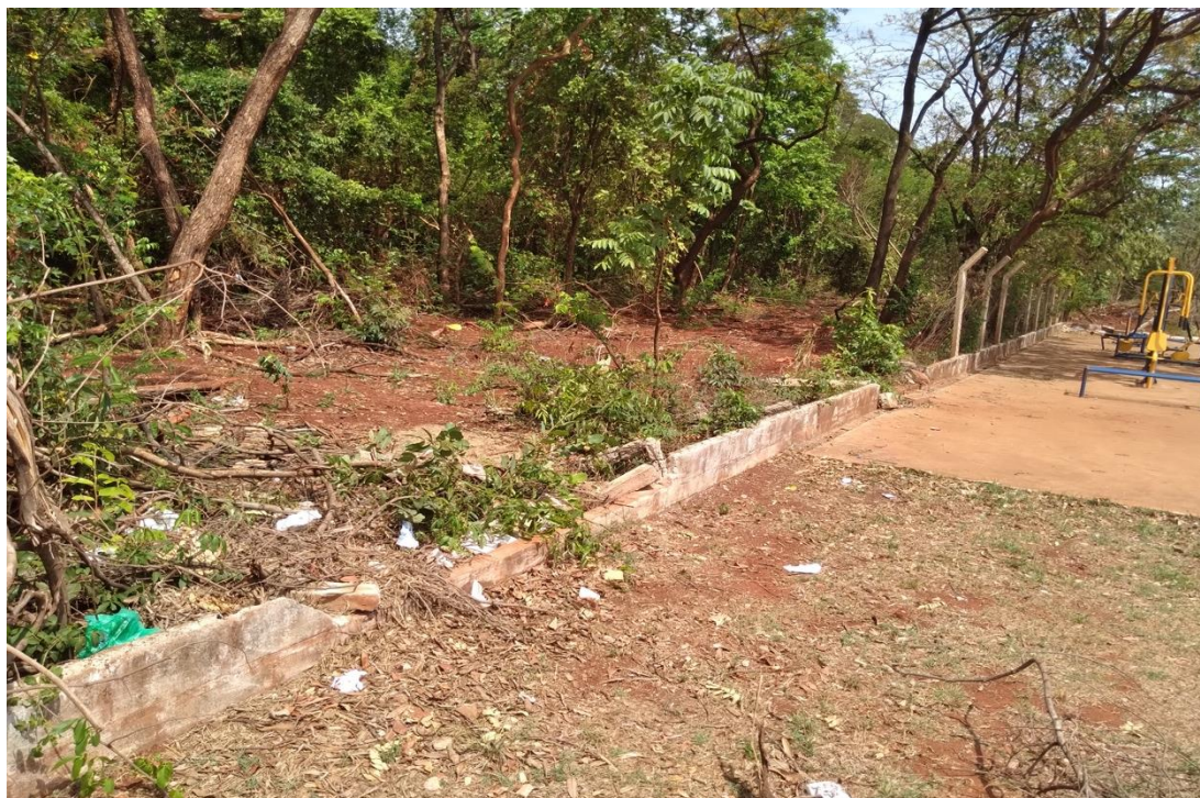
Figura 03 - Vista do local onde observa o alambrado danificado, evento que restou diversos prejuízos ao nosso município.
